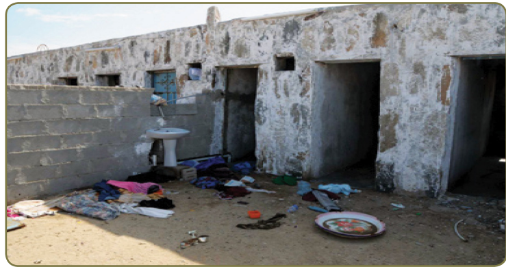
إحدى المباني المتهاكلة في القرى
