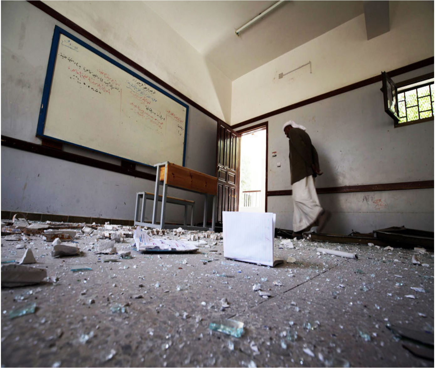
صورة لمدرسة في صنعاء تضررت إثر تعرض مبنى مجاور لها لضربة جوية - Photo: UNICEF/ Mohammed Mahmoud
